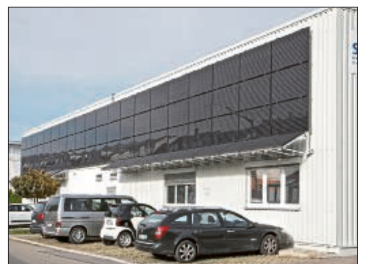
Strom für den eigenen Bedarf: Photovoltaikanlage an der Südfassade.
